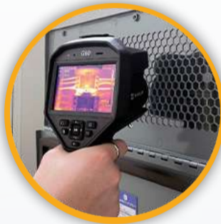
Termografía de equipos industriales y tableros
